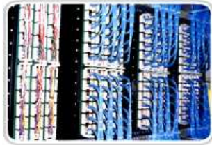
Patch panels UTP en un bastidor
